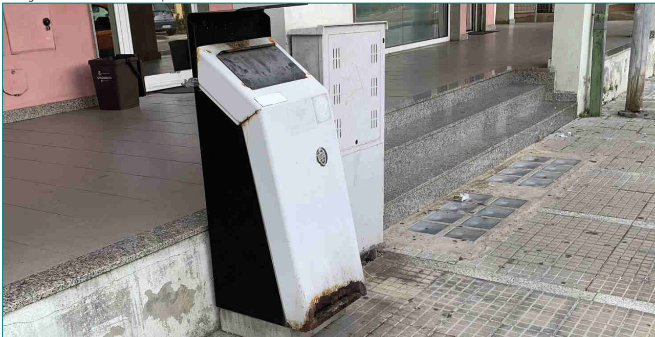
immagine 47 Contenitori stradali per i RUP in cattivo stato di conservazione.
